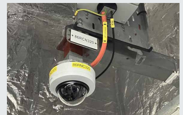
Kamerainstallationen im Innenbereich. [Quelle: Securiton Deutschland]
